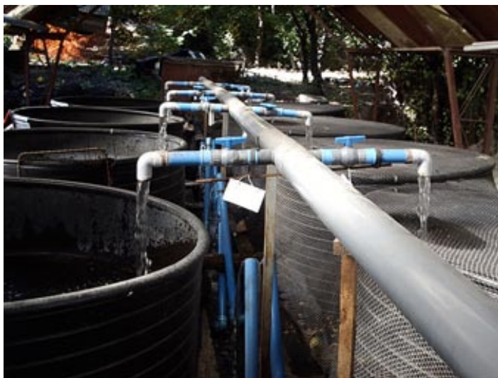
Estanques de polietileno de alta densidad.
